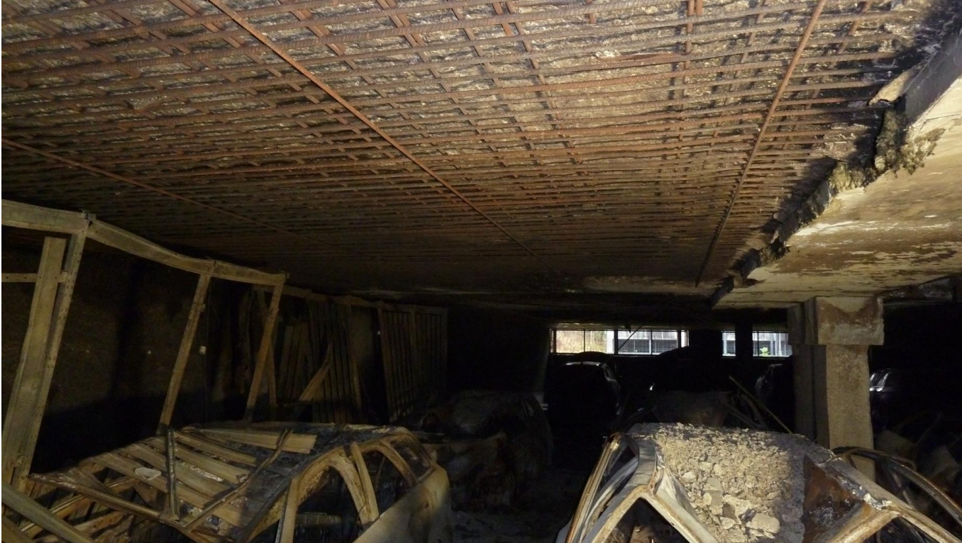
Rycina 2. Skutki pożaru w garażu przy ul. Górczewskiej w Warszawie 16 października 2020 r. Autor: R. Kowalski
